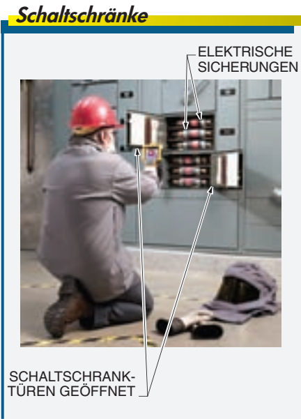
Abbildung 3-3. Wenn Gehäuse von elektrischen Betriebsmitteln geöffnet werden müssen, sind Verfahren zur Minimierung des Lichtbogenüberschlagsrisikos sorgfältig zu entwickeln, zu implementieren und einzuhalten. Wenn Gehäuse geöffnet werden müssen, sind entsprechende Verfahren zur Minimierung des Lichtbogenüberschlagsrisikos sorgfältig zu entwickeln, zu implementieren und einzuhalten. National Fire Protection Agency (NFPA) 70E ist eine von mehreren Normen, die bei der Entwicklung derartiger Verfahren nützlich sein können.
