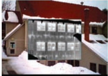
Figura 5-63. La presencia de muchas zonas calientes en la fachada de un edificio está asociada a la mala instalación del aislamiento de fibra de vidrio.
