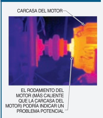
Figura 2-2. Cuando el rodamiento de un motor está significativamente más caliente que la carcasa, es posible que se trate de un problema de lubricación o de alineación.
