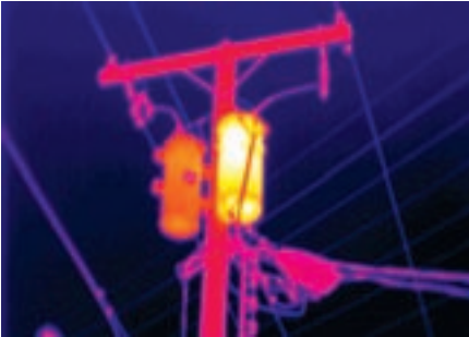
Figura 5-84. Esta imagen térmica indica que el transformador de la derecha puede tener una avería interna.
