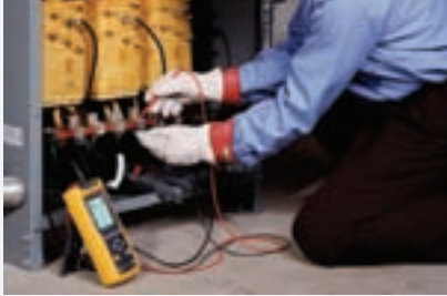
Figura 10-2. El análisis eléctrico hace uso de equipos de monitorización eléctricos para evaluar la calidad de la energía eléctrica suministrada al equipo.
