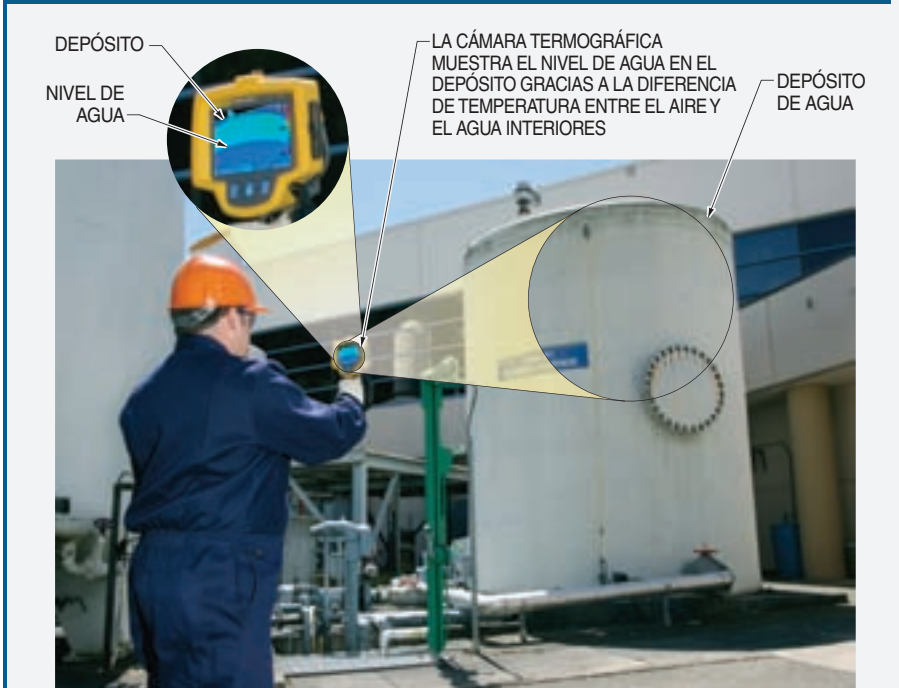
Figura 6-4. Una de las aplicaciones más comunes en termografía es la localización o confirmación de niveles de material en recipientes como depósitos o silos.
