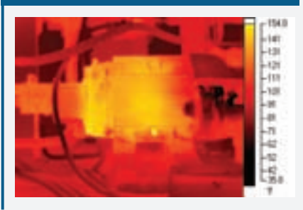
Figura 7-2. Aparecerán muchas diferencias en la firma térmica del motor en inspecciones térmicas posteriores.
