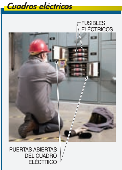
Figura 3-3. Cuando es necesario abrir cuadros eléctricos, deben desarrollarse procedimientos, implementarlos y cumplirlos rigurosamente con el objeto de reducir al mínimo el riesgo de formación de arcos de tensión.
