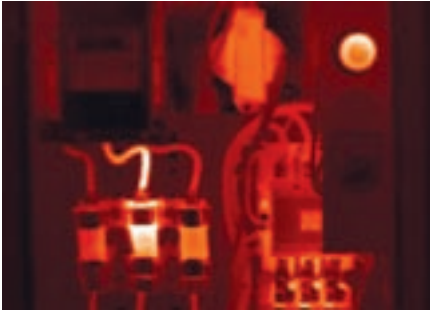
Figura 5-44. La conexión al portafusibles en el centro de control de motores (CCM) está más caliente de lo normal.
