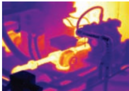
Figura 5-19. Con el conocimiento apropiado sobre el equipo mecánico, un técnico puede realizar muchas tareas de resolución de problemas y de mantenimiento.
