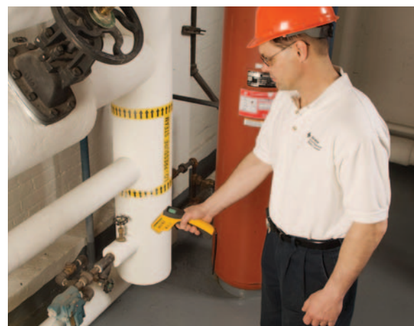
HLK-Techniker Darryl Dylla prüft mit einem Infrarot-Thermometer Fluke 62 die Kondensatabscheider im HLK-System.
