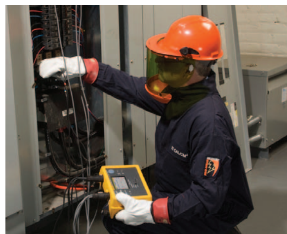
Der Elektriker Rolf Zoeller führt mit dem dreiphasigen Power Logger Fluke 1735 Lastgangstudien an den elektrischen Systemen der Einrichtung durch. Die äußerst intensive Überwachung dieser Systeme hat zur ENERGY STAR-Bewertung des Krankenhauses beigetragen.
